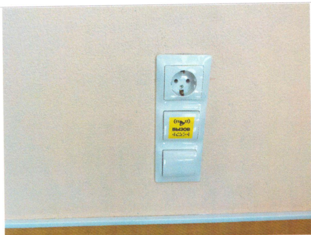
Фото №37 – Кнопка вызова персонала (расположена у каждой кровати)
